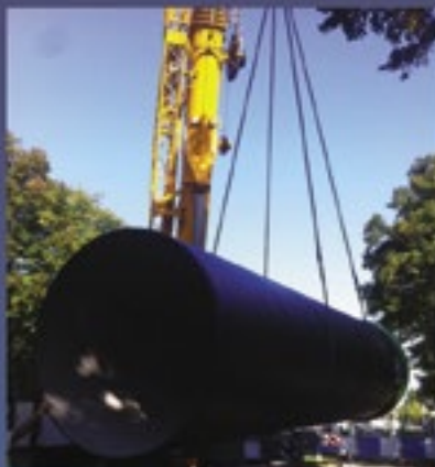
Réalisation d'un bassin de stockage des eaux Fonte diam. 2 000 X 250 m linéaires MEUDON
