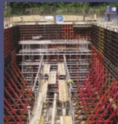
Bassin de stockage 2 000 M 3 SARTROUVILLE
