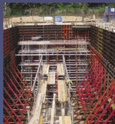
Bassin de stockage 2 000 M 3 SARTROUVILLE
