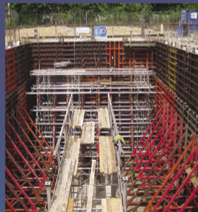
Bassin de stockage 2 000 M 3 SARTROUVILLE
