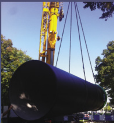
Réalisation d'un bassin de stockage des eaux Fonte diam. 2 000 X 250 m linéaires MEUDON
