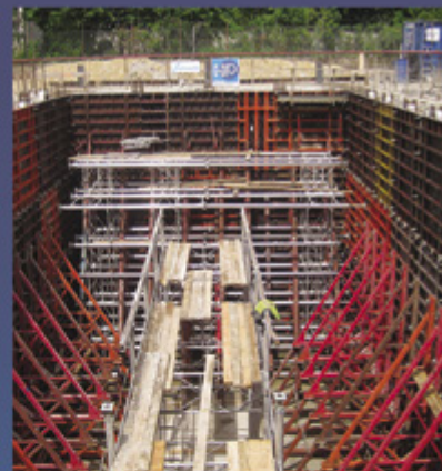
Bassin de stockage 2 000 M 3 SARTROUVILLE
