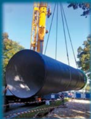
Réalisation d'un bassin de stockage des eaux Avenue du Château à MEUDON Fonte diamètre 2000 sur 250 mètres linéaires
