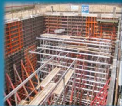
SARTROUVILLE – Rue des Eaux Bassin de stockage >2 000m 3
